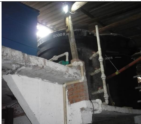
Foto No. 5 Sistema de tratamiento de ARnD.
