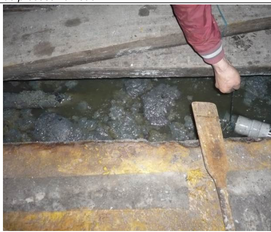
Foto No. 6 Trampa de grasas.
